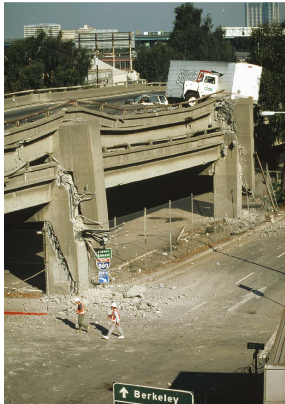
41 mennesker blev dræbt, da denne motorvejsbro i San Francisco styrtede sammen.
